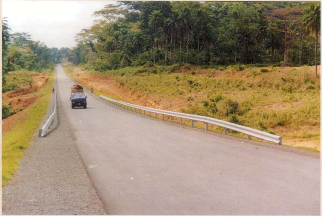
جانب من مشروع طريق في غينيا أحد المشروعات المنفذة بنظام التمويل المشترك
