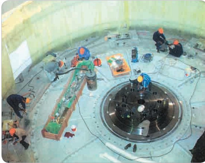
• إحدى توربينات السد قيد التجهيز قبل دخول الخدمة
