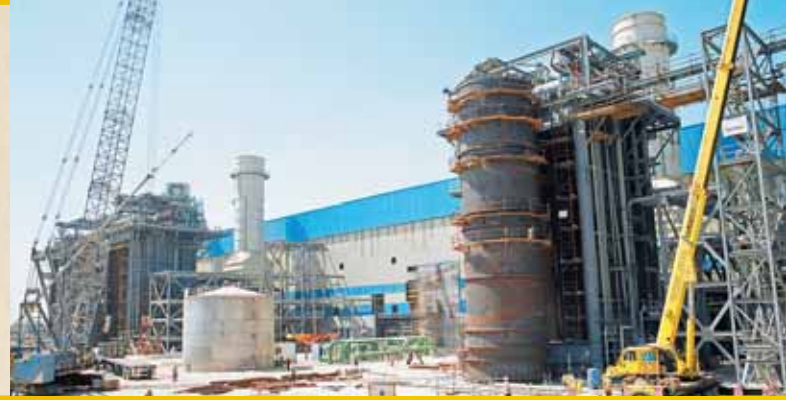
• جانب من محطة كهرباء النوبارية التي يمولها الصندوق
